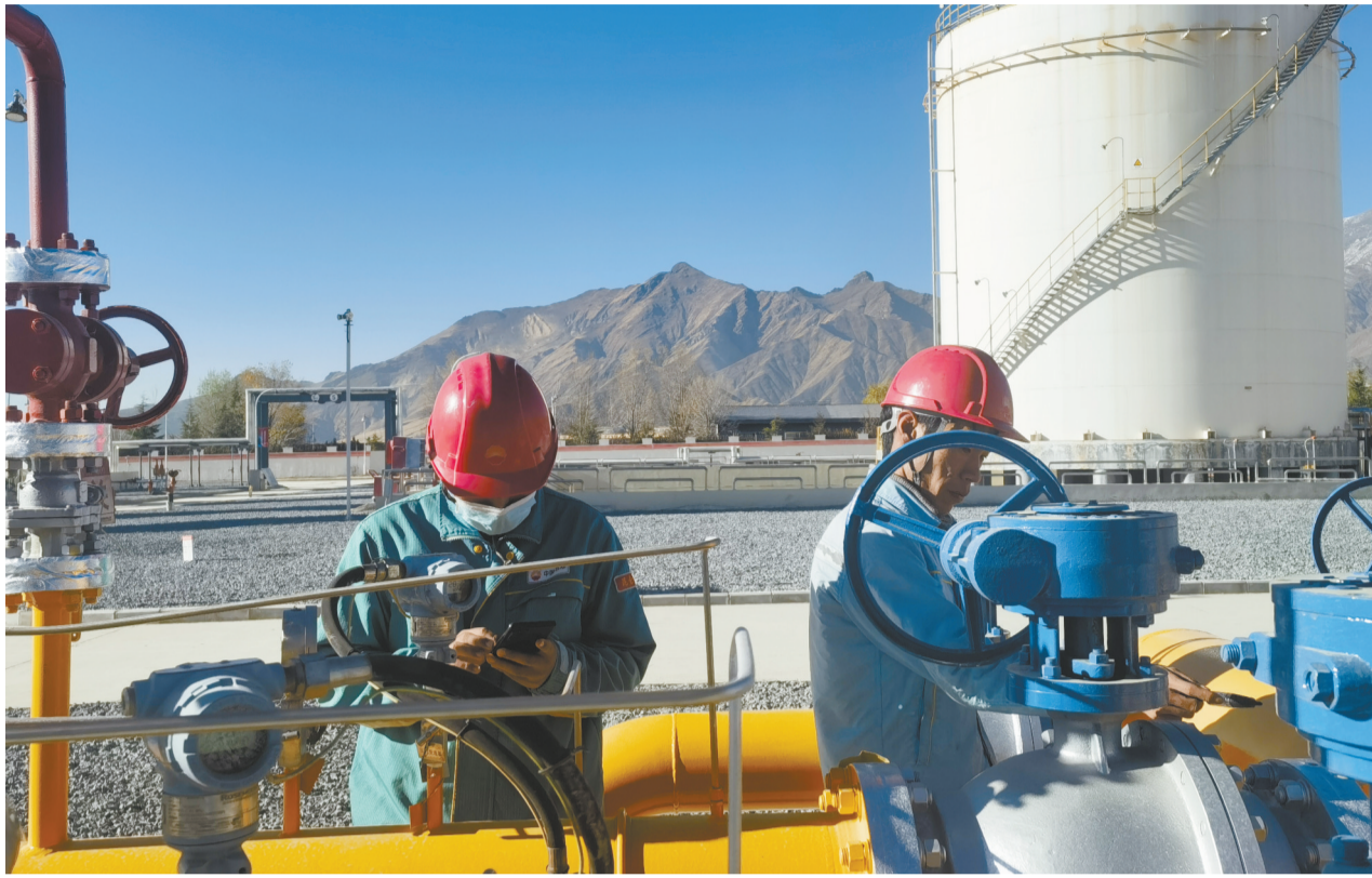
图为拉萨天然气站工作人员在计量区对管线进行巡检检测。
