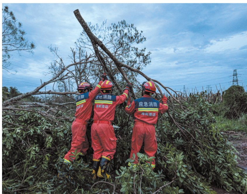
图为9月7日，在海南省澄迈县一条被台风刮倒的大树阻塞的道路上，澄迈县消防救援大队救援人员进行清障作业。
