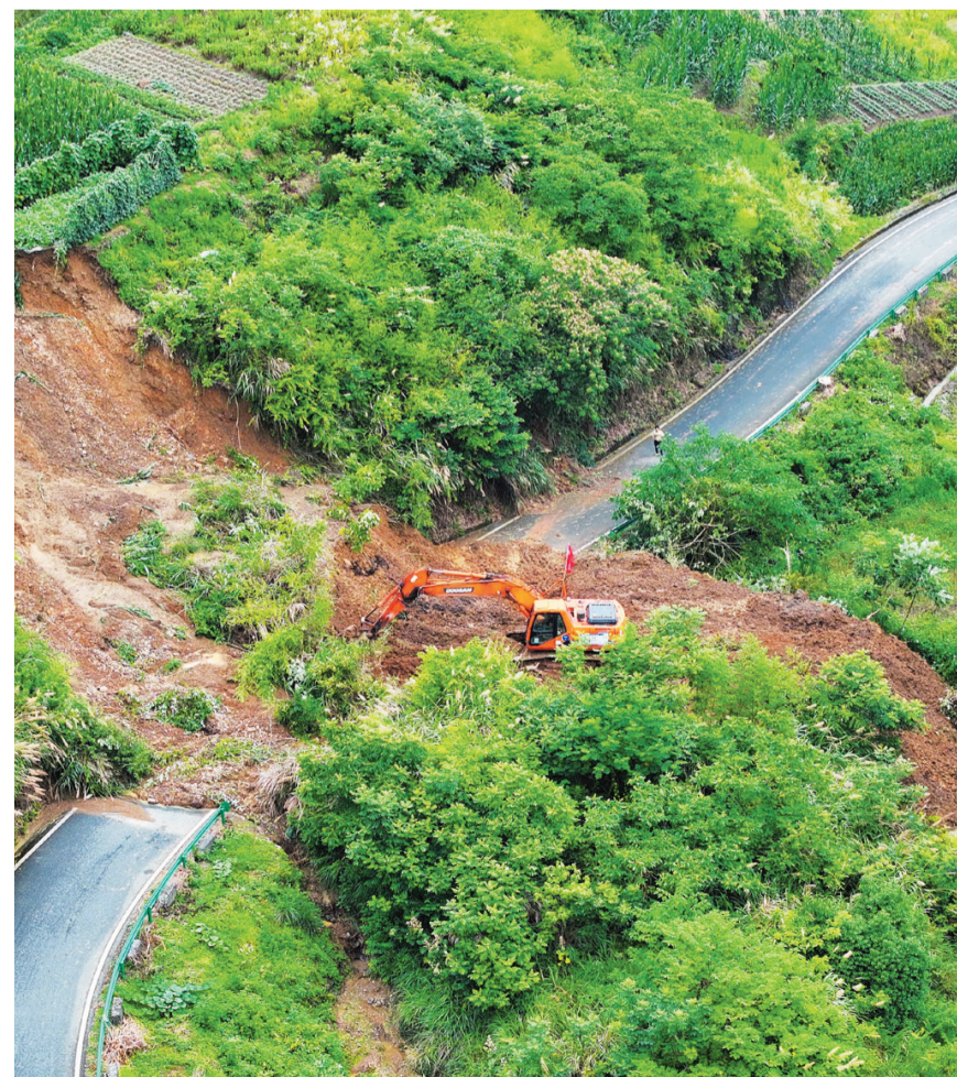
近日,强降雨导致安徽省黄山市歙县桂林镇宋村村境内008县道出现多处塌方。记者在现场看到,多处路段因塌方堵塞,部分道路出现损毁,抢险救援力量正在对塌方路段进行疏通。这是6月21日拍摄的歙县桂林镇008县道一处塌方点(无人机照片)。新华社记者 杜宇摄
