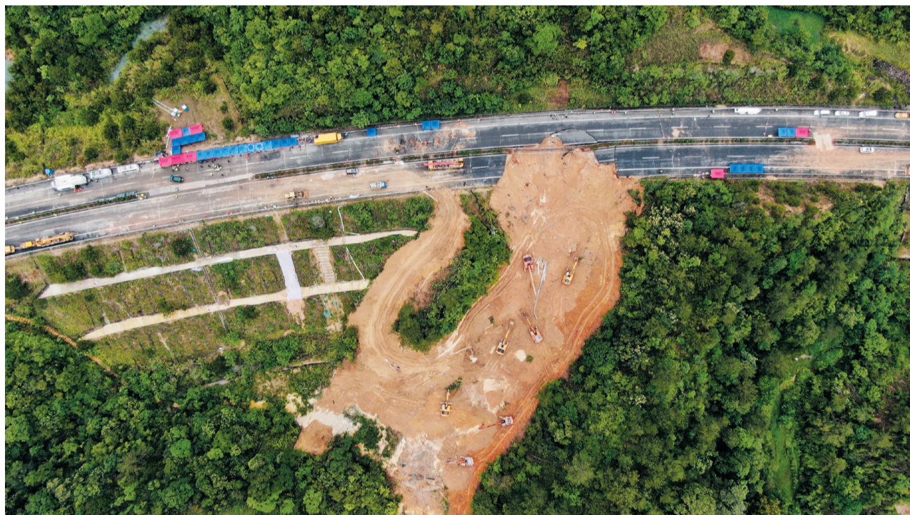
这是5月2日拍摄的广东梅大高速茶阳路段塌方灾害现场（无人机照片）。
