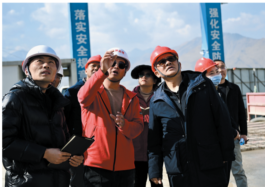
4月9日至10日,市委副书记、市长王强深入达孜区、堆龙德庆区,实地调研产业发展、项目建设、基层治理、城市精细化管理等工作。图为在区市粮食和应急物资储备中心项目建设现场,王强详细了解项目建设、资金保障、配套设施等情况。拉萨融媒记者 多吉吉布摄
