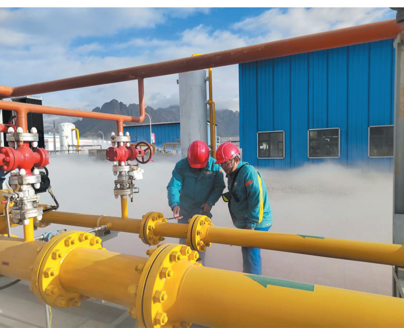
图为拉萨天然气站工作人员在对站内设施设备进行全面检查。拉萨融媒记者 李从芳摄
