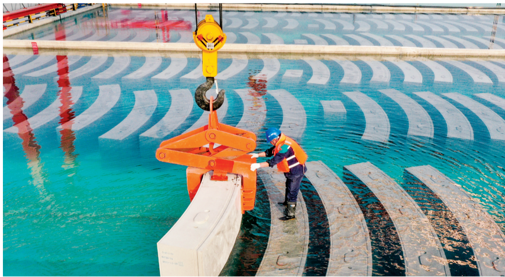
12月30日是元旦假期第一天。劳动者们爱岗敬业,扎实工作,坚守岗位。这是当日,在成渝中线高铁青白江管片厂,中铁十一局的工人将管片辅助吊入水养池(无人机照片)。
